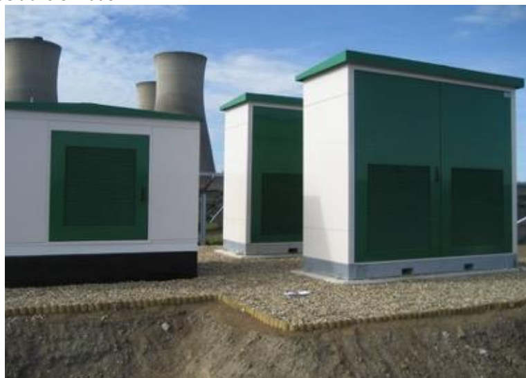
Photo 42 : Exemple de poste de transformation
